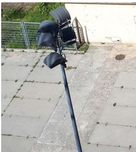
Fot. 14 – Maszt stalowy z oprawami
